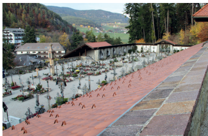
Die beschädigte Wasserleitung für die Bewässerung des Friedhofes Lengmoos muss erneuert werden
